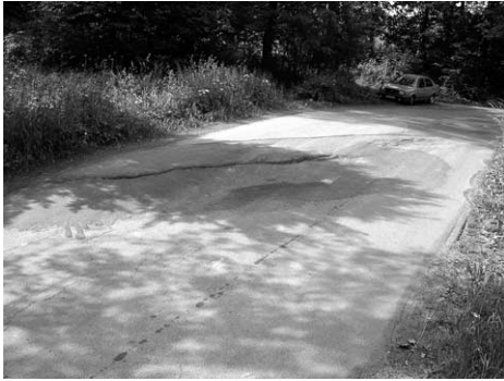
Ryc. 1. Osuwisko w Sękowej, które przecina droga powiatowa
