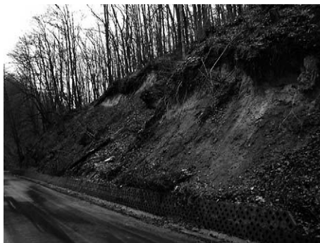
Fot. 5. Procesy osuwiskowe przy drogach poprowadzonych wzdłuż wąwozów lessowych (fot. A. Borecka)
