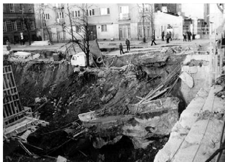
Ryc. 1. Katastrofa ściany szczelinowej – Europlex w Warszawie
